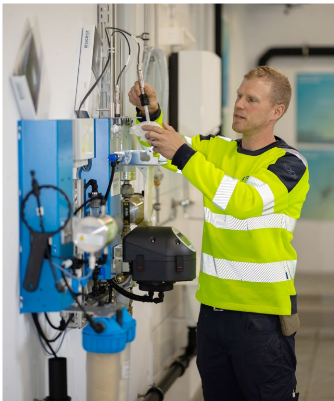
Der Anlagenunterhalt ist ein zentraler Bestandteil der Qualitätssicherung und somit für die Gewährleistung einwandfreien Trinkwassers unerlässlich.
