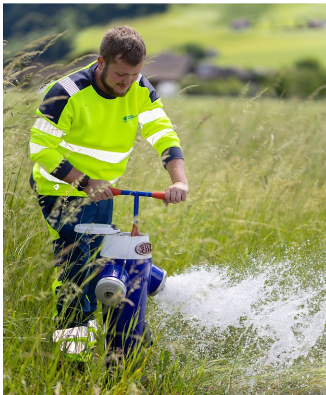
Die regelmässige Hydrantenkontrolle inklusive Spülen ist ein wichtiges Element für die verlässliche Löschwasserversorgung im Brandfall.
