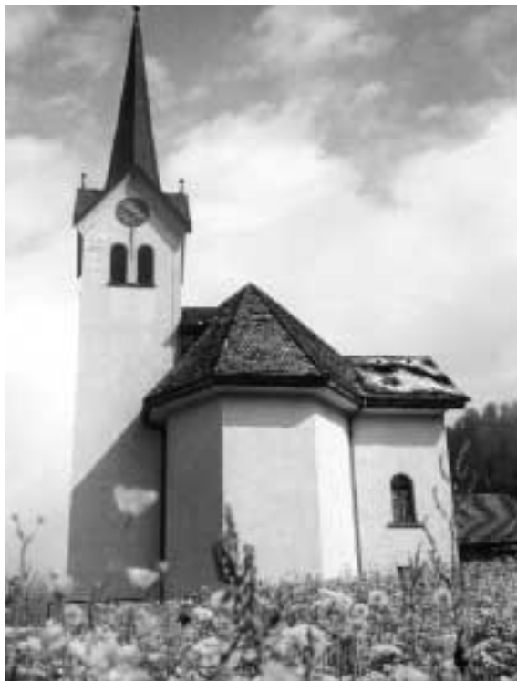
Das Kirchendach der Gnadenkapelle ist auffällig und muss unbedingt erneuert werden
